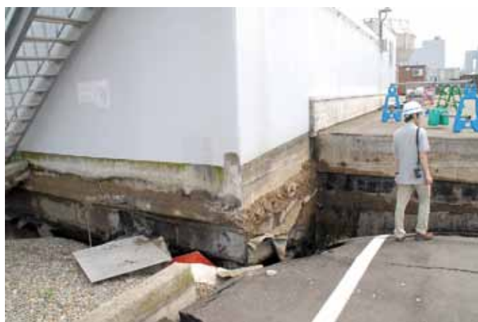
地盤沈下によって、土台がむき出しになった柏崎刈羽原子力発電所の建物 写真提供：柏崎日報社
