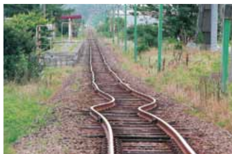
歪んだ線路(JR越後線) 写真提供: 柏崎日報社
