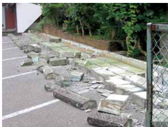
倒れたブロック塀
